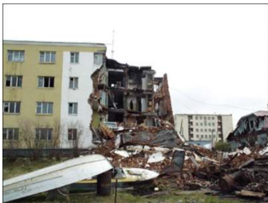
Рисунок 291 – Обрушившаяся из-за неравномерной просадки грунта секция здания в пос. Черский
