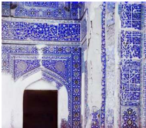
Рисунок 265 – Разрушенная мозаичная отделка Шах-Зинде
