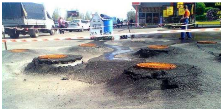
Рисунок 292 – Просадка грунта под проезжей частью
