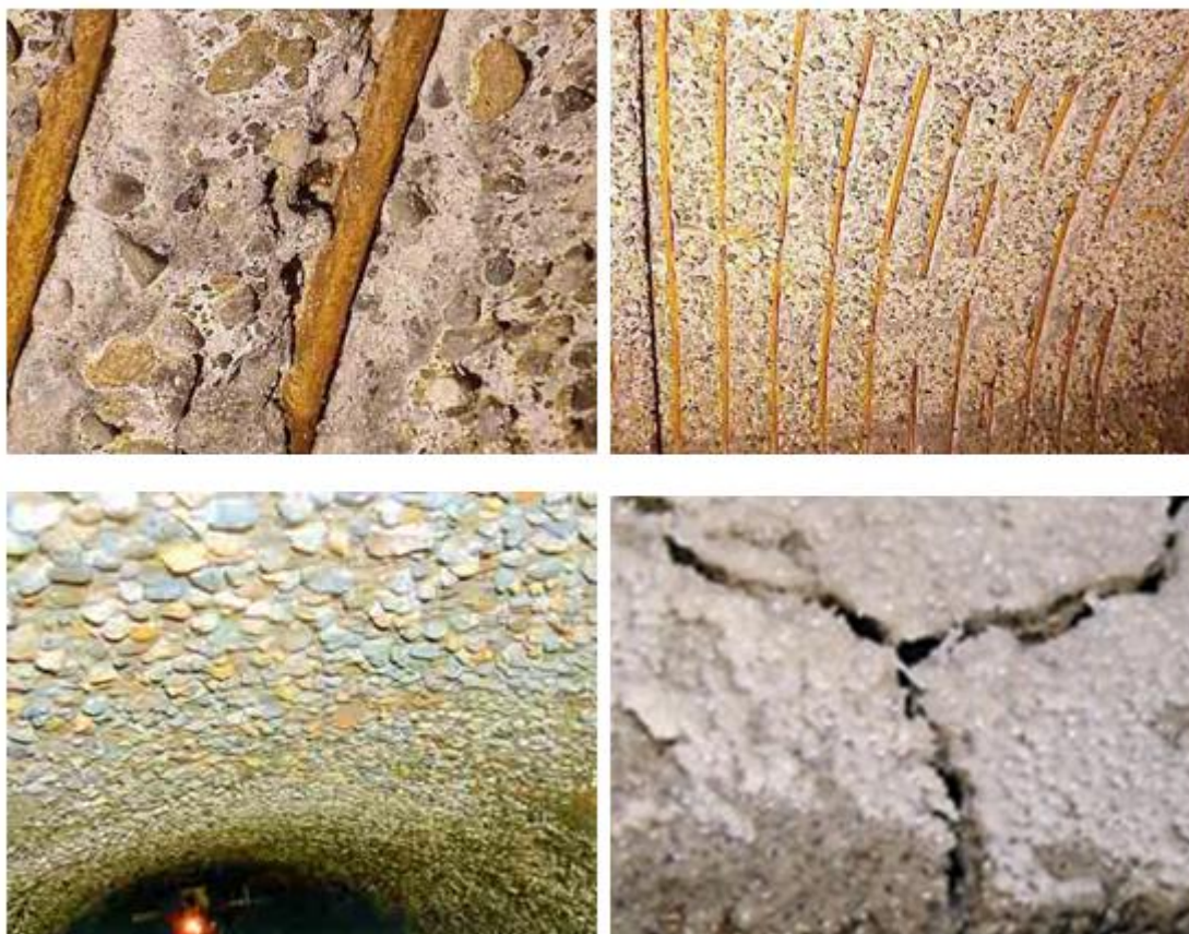
Рисунок 4.8 – Коррозия цементного камня бетона
