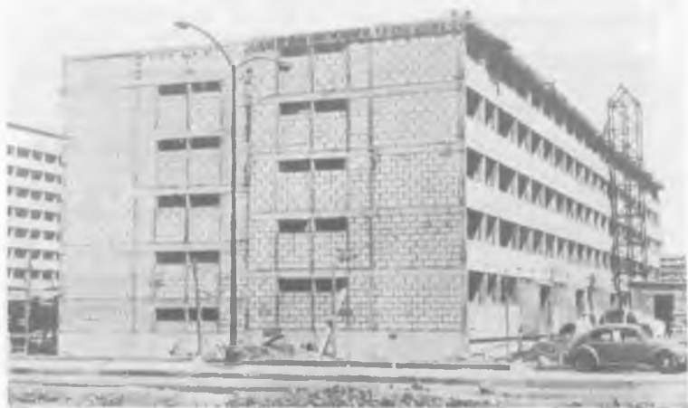
Рис. 23. Пятиэтажные жилые дома с несущими стенами из ячеистобетонных блоков, обвязочными балками и колоннами из плотного бетона для восприятия сейсмических нагрузок (Мексика)
