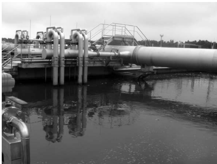
Фото 6.3. Очистные сооружения сточных вод г. Варшавы (Польша)
